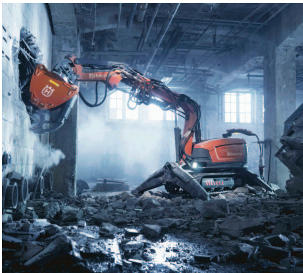
Dálkově ovládaní demoliční roboti Husqvarna se hodí jak do nebezpečných oblastí, tak do prostorů, kam byste se těžko dostávali s klasickým rýpadlem.
